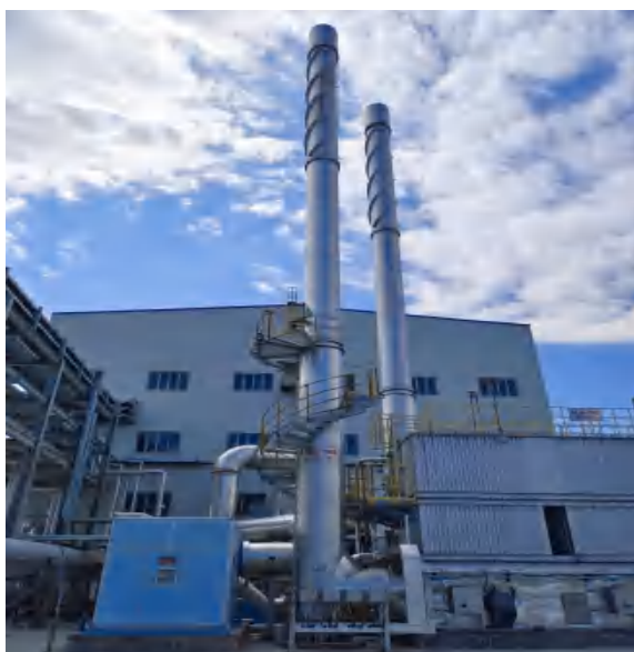
RTO 炉废气排放口
