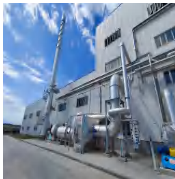
卷帘式过滤器末端排放口
